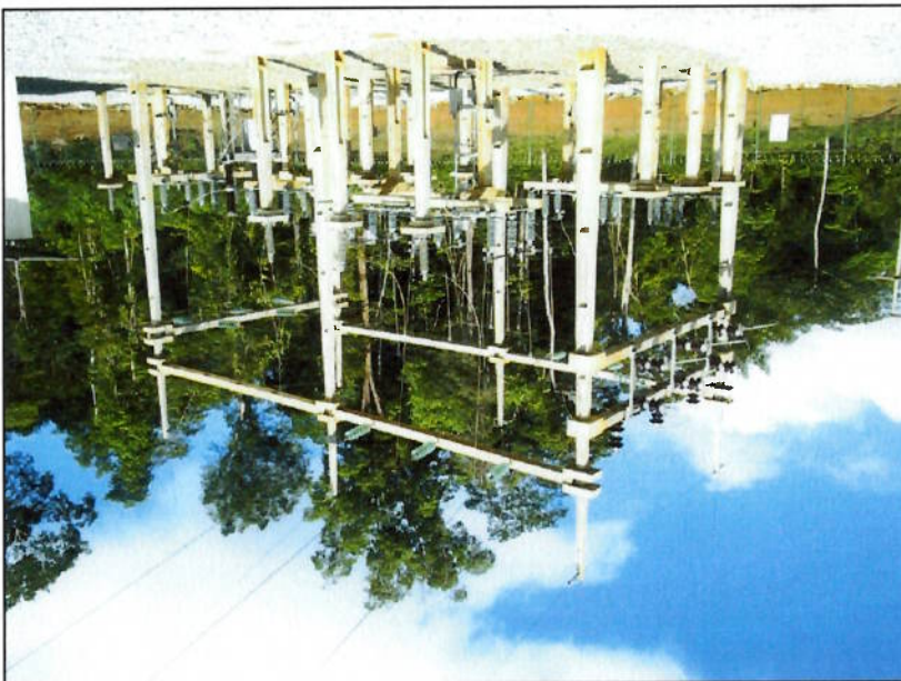
Figura 2 – Exemplo de subestação rebaixadora Fonte: Arquivo Particular
